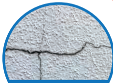
外壁 ・クラック(ひび)
