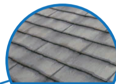
屋根 ・汚れ、割れ、欠損
